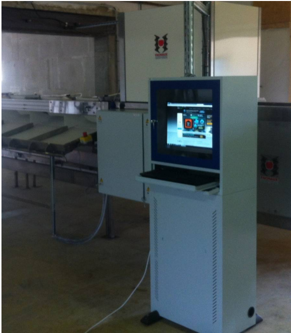
Baie informatique de commande
