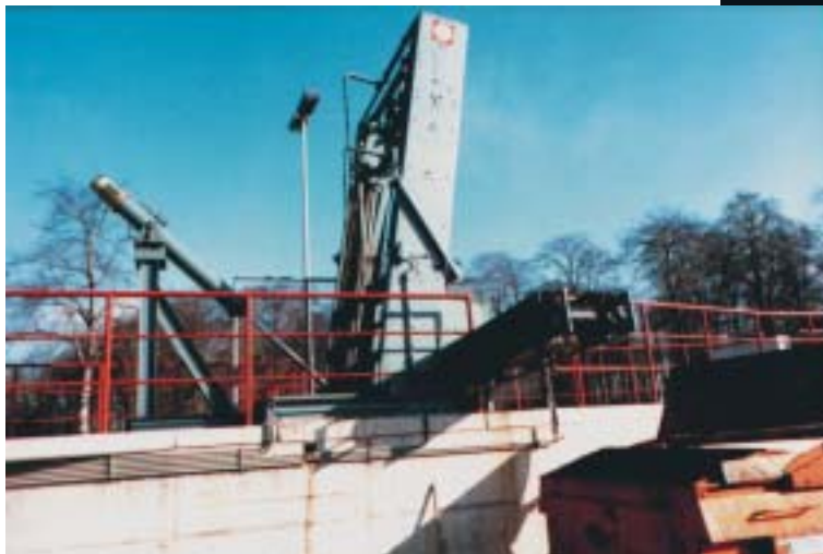
Kläranlage Antrieb zur Rechen- betätigung
