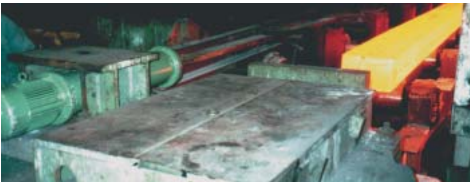
Rollgang Antrieb dient zur Brammenausrichtung
