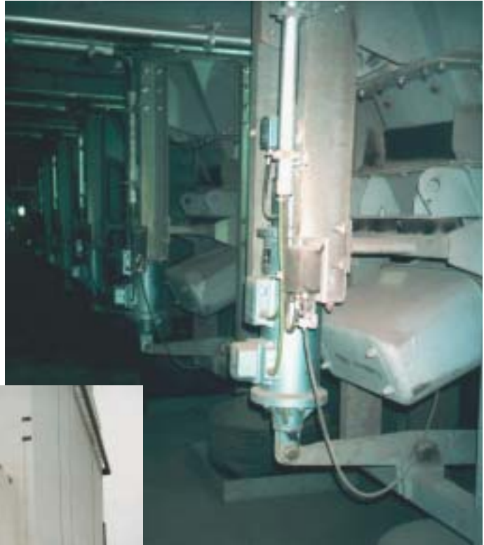
Prüfgewichtsbetätigung im Stahlwerk
