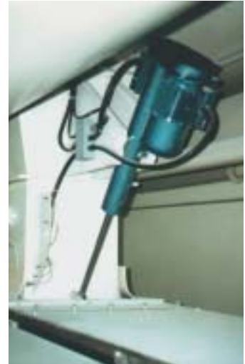
Siloauslauf zur Bandbeschickung
